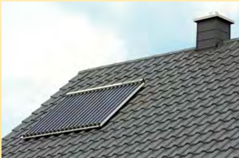
Moderne Solarkollektoren mit Vakuumröhren brauchen durch höhere Effizienz nur wenig Platz.
